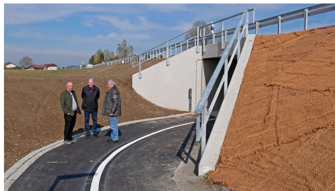
Hier die südliche Rampe zur Untertunnelung. Die Böschungen wurden teils mit Netzen befestigt. Neben der Fahrbahn sind nun Leitplanken montiert.
